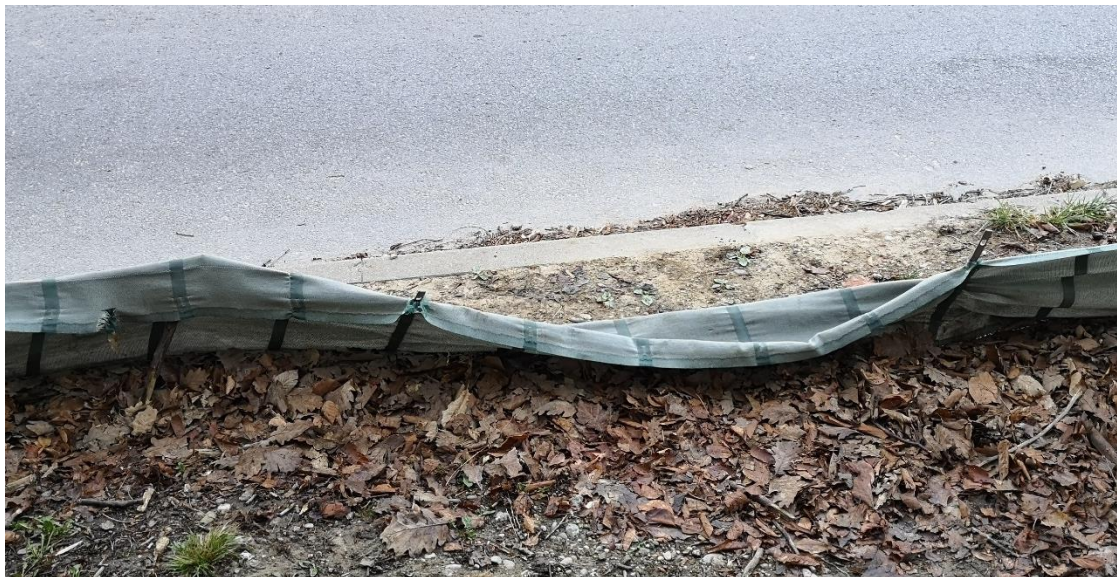
Slika 6: Uničena ograja na odseku 5 (Avtor: Mo Lipovec).
