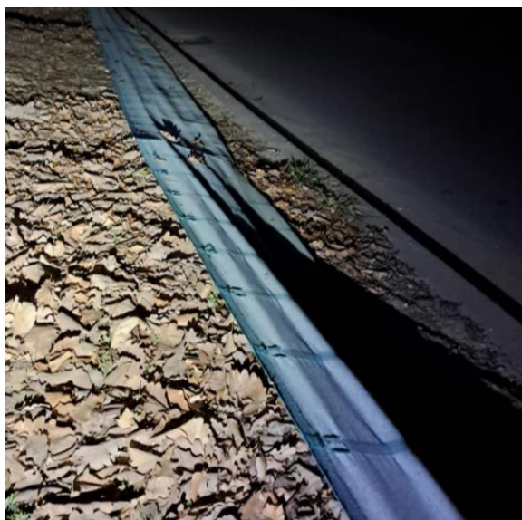
Slika 13. Povožena ograja in posledično poškodovani klini (Slika: Karmen Zemljak)
